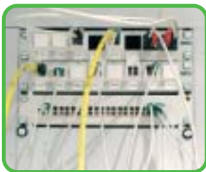
Zentraler Patchverteiler für die flexible Zuordnung von Datenquellen auf die in allen Räumen platzierten 4-fach-Anschlussdosen
