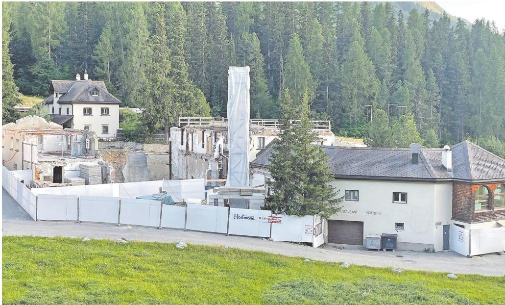
Der ehemalige Landgasthof Meierei gleicht derzeit eher einer Bau ruine als einem Luxusresort mit geplanten Suiten.
